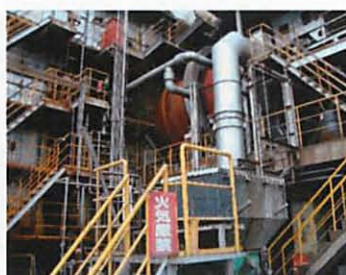
写真-8 燃焼炉外観
