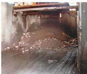
写真-10 炉壁付着スラグ・煉瓦
