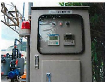
写真-4 油水分離操作盤
